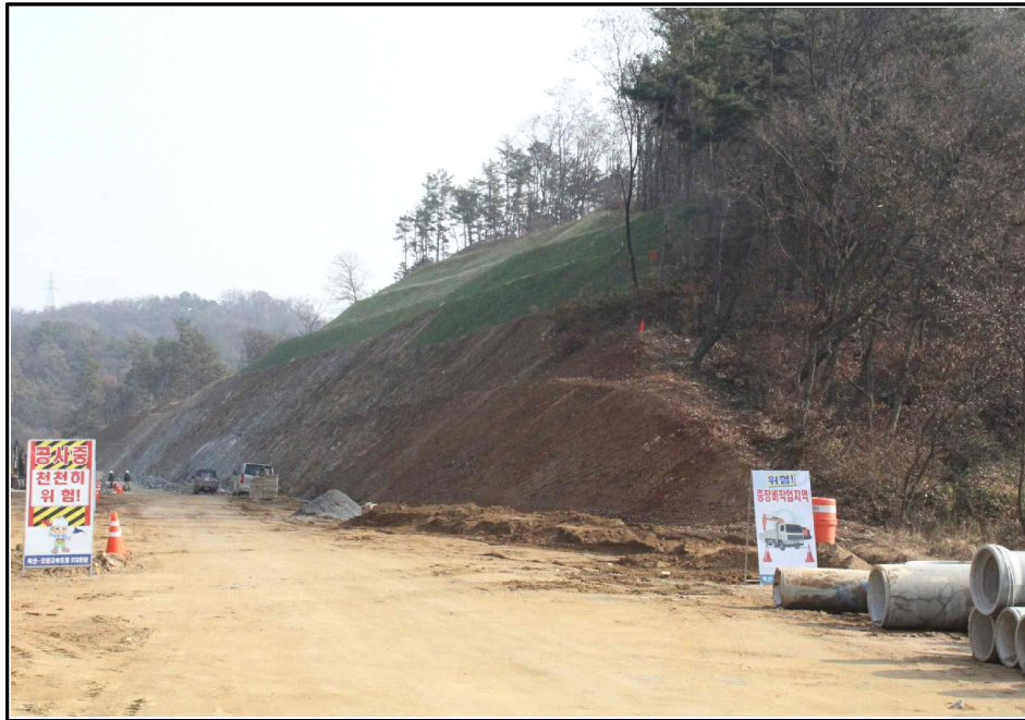
【그림 3】 깎기비탈면 시점부 측면 사진
